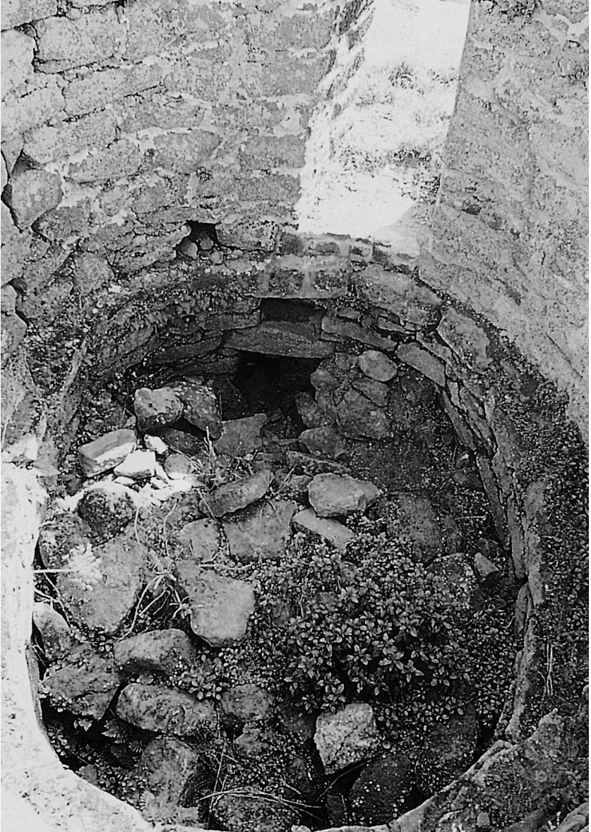
Fig. 43. Il Nuraghe Oes: particolare della camera con finestrone e risega anulare per sostenere il solaio in legno.
